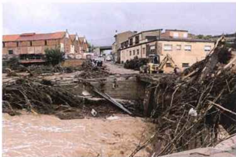
Pont de la font Baixa de l'Espuga de Francolí després de la riuada del 22 d'octubre de 2019.
