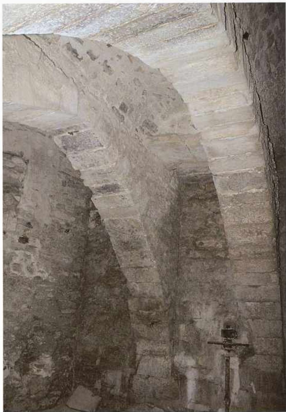
Vallfogona. Molí de la Cadena, de Baix. Interior de la sala de moles amb arcs diafragma coberts originàriament de lloses de pedra. (JFS)
