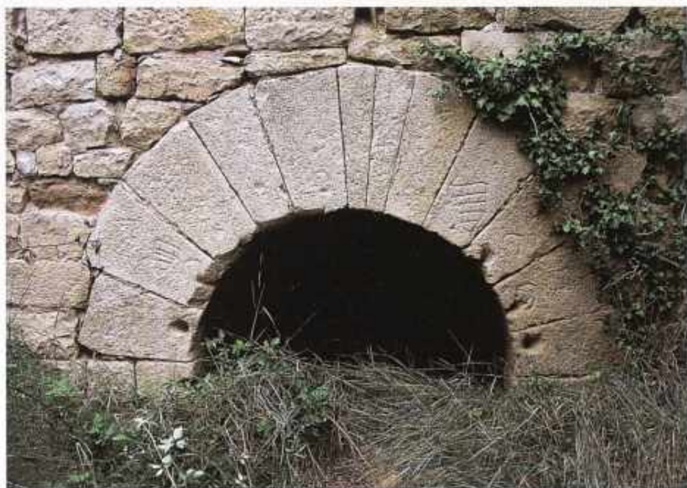
Sarrià. Molí del Temple. Aquest molí, que va pertànyer als templers i després als hospitalers de Montbrí, mostra a la porta l'heràldica de fra Guillem de Guimerà, gran prior de Catalunya a finals del XIV. (JFS)
